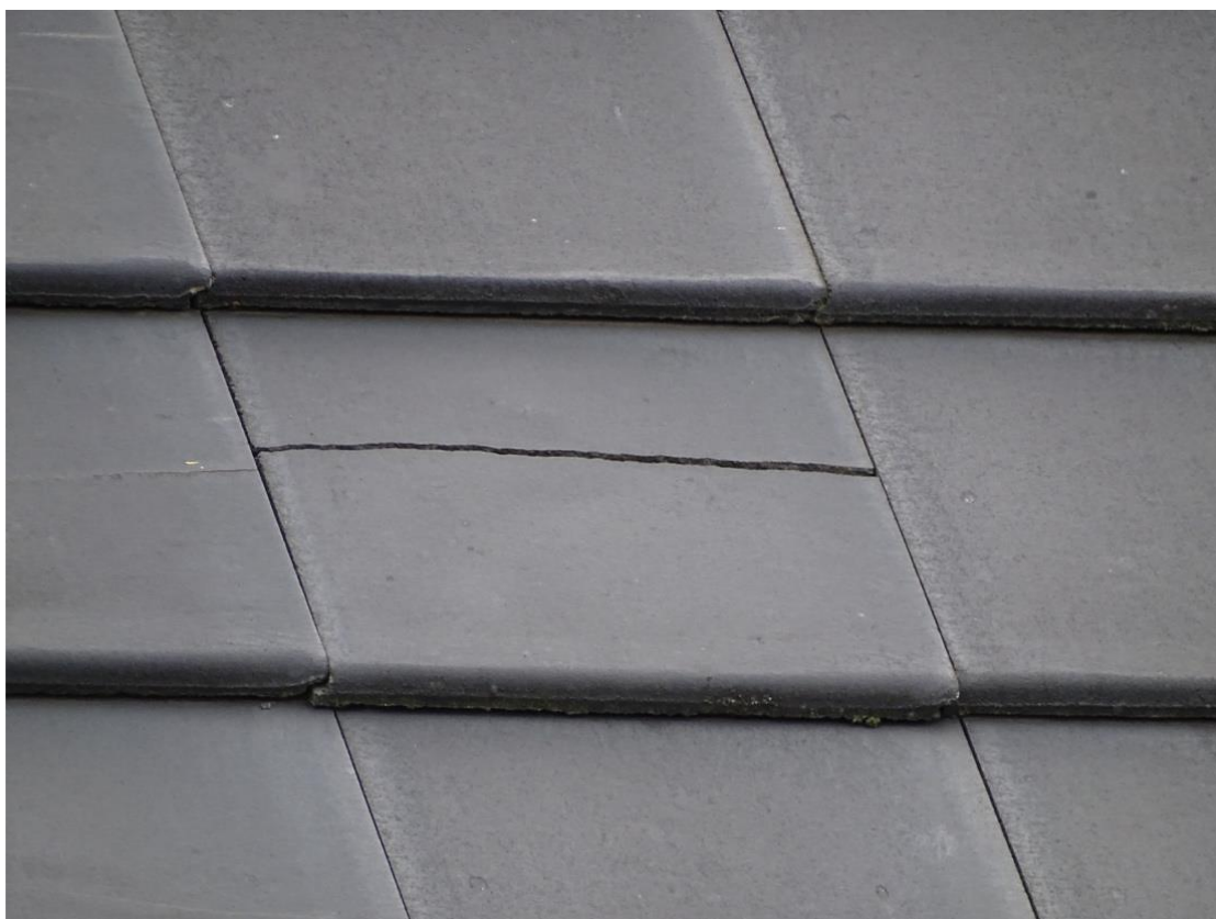
Fot. 5. Pęknięta dachówka cementowa do wymiany
