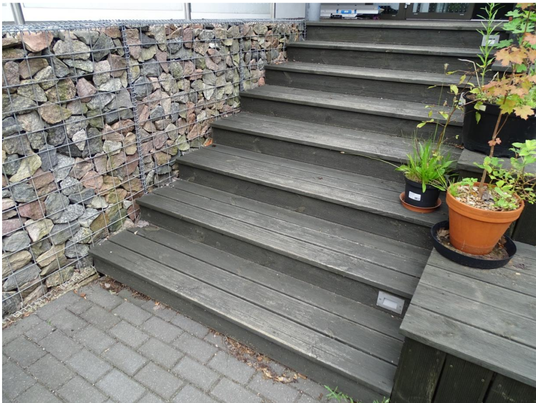
Fot. 1. Stan tarasu na dziedzińcu wewnętrznym wskazany do konserwacji
