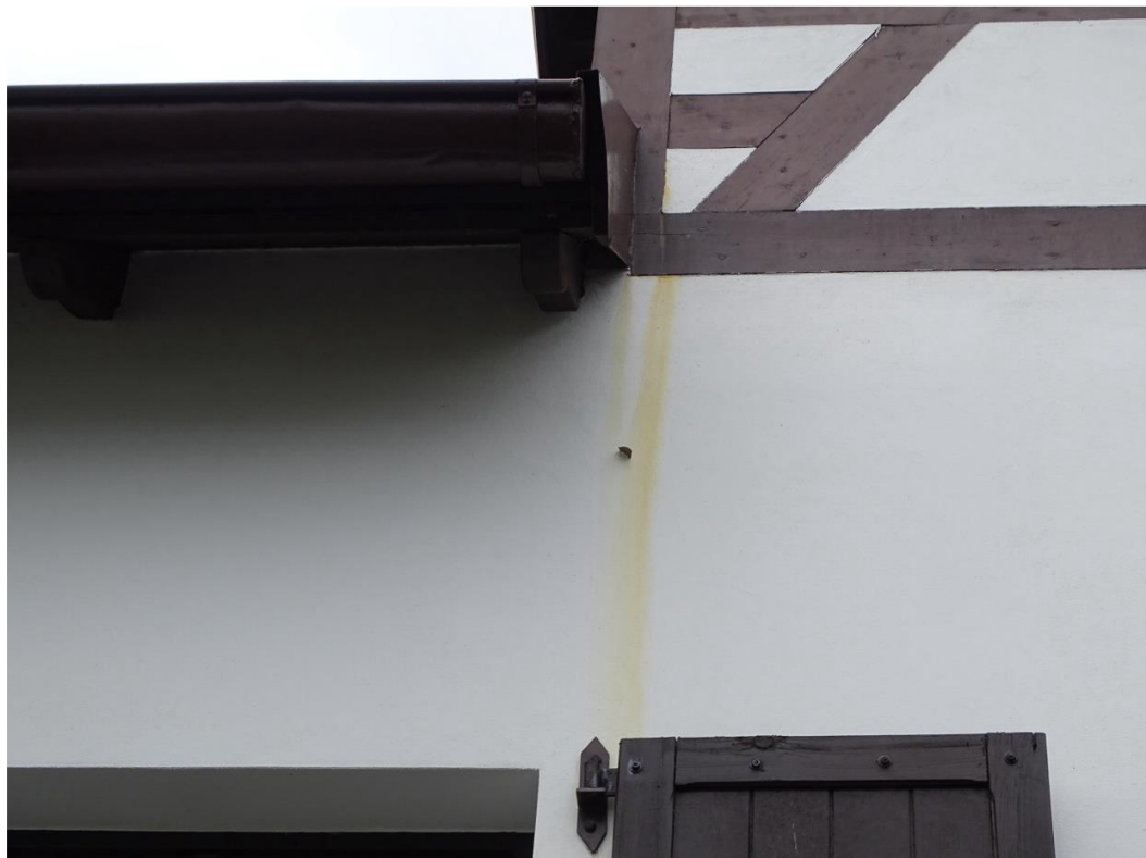
Fot. 4 Zabrudzenia elewacji wschodniej do usunięcia
