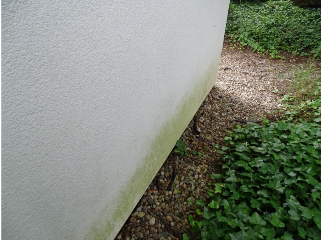
Fot. 3. Zabrudzenia elewacji w przyziemnej części budynku
