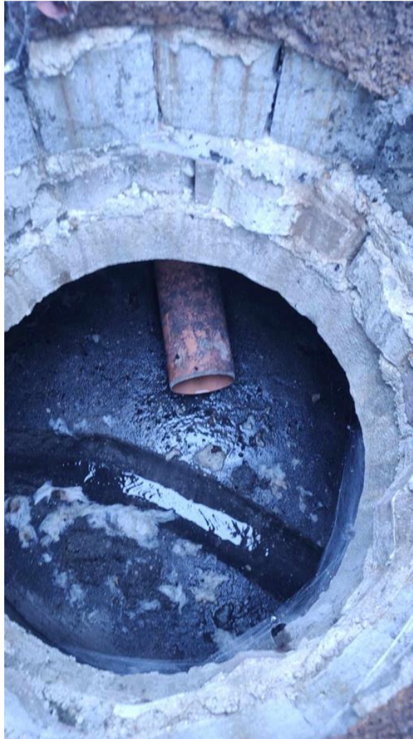
Fot. 8. Aktualny sposób odprowadzenia rury sanitarnej do studzienki kanalizacyjnej
