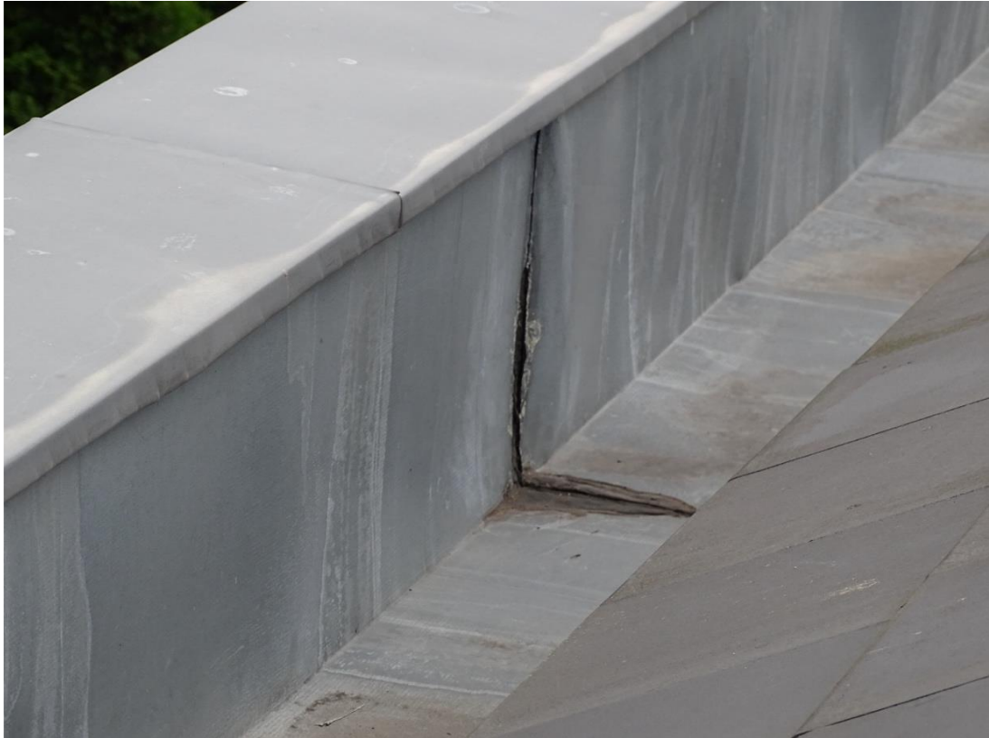
Fot. 6. Pęknięta dachówka cementowa do wymiany
